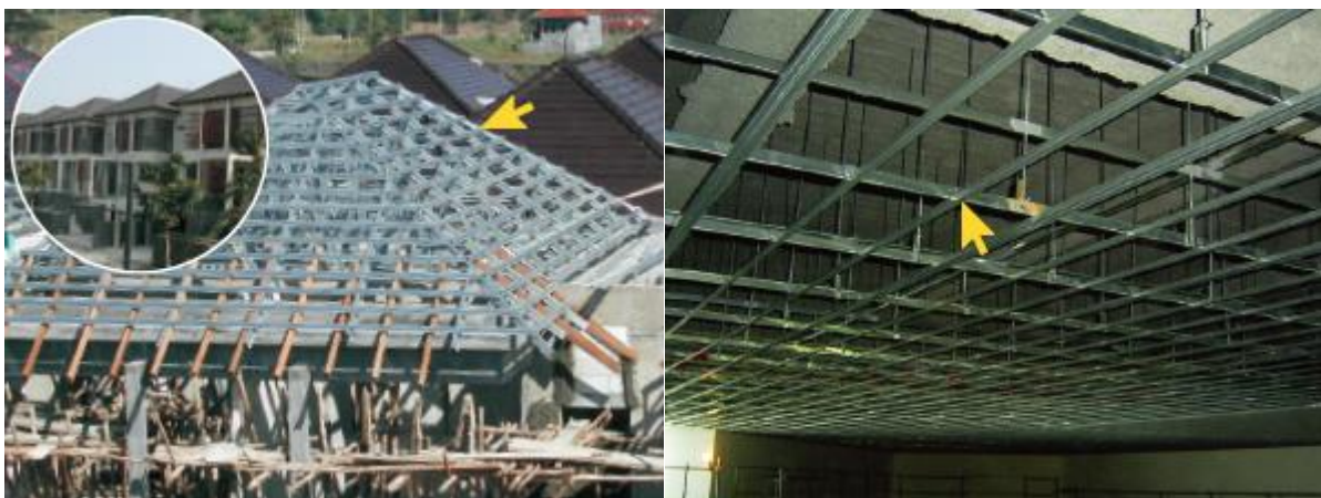
รูปที่ 3.28 โครงหลังคา และโครงฝ้าเพดานที่ผลิตมาจากเหล็กแผ่นเคลือบ Zn-Al-Mg alloy ที่มา : http://www.zam.biz/en/case/construction/
