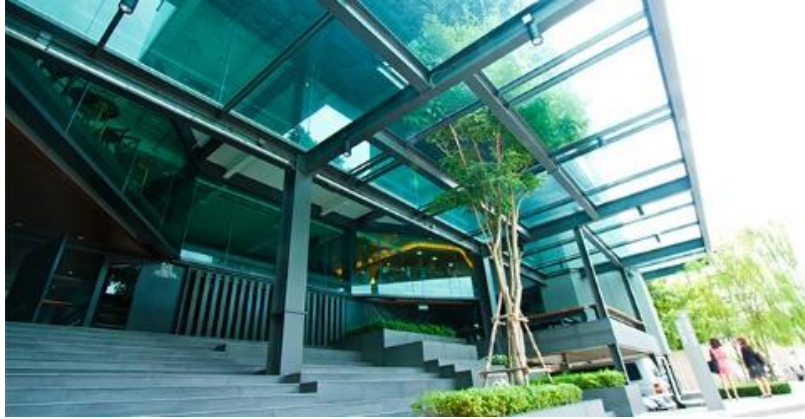
รูปที่ 3.7 การใช้งานผลิตภัณฑ์เหล็กโครงสร้างรูปพรรณรีดร้อน รูปตัวเอช (H beam) ในงานโครงสร้าง ที่มา : https://www.syssteel.com/product/?type=1#sys-products
